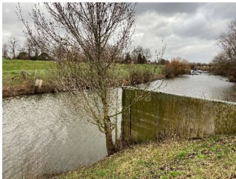
Figuur 13: asbestcementplaten in het koelwaterkanaal
